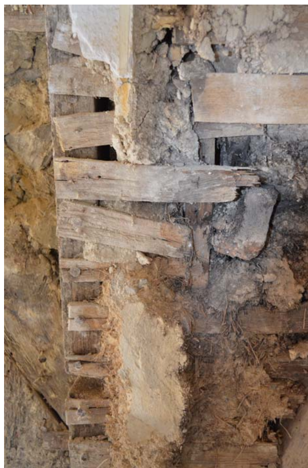
Fig.28 L'enduit à la base de la cerce 137 et l'arrachement du lattis © Rozenn Battais, Inrap
