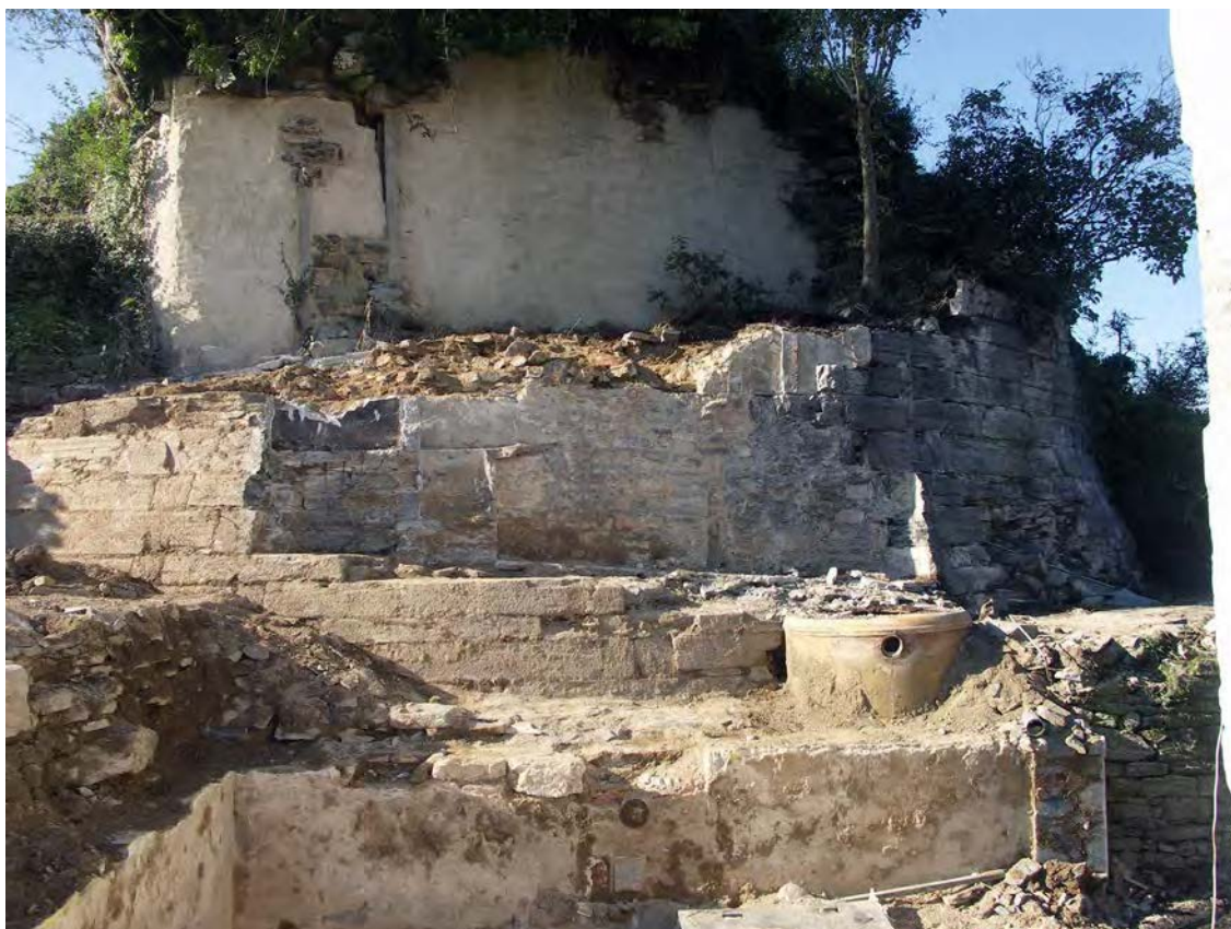
Fig. 86 : Vestiges du parement de la tour d'artillerie et de son glacis, côté sud. La disparition du parement, au centre, donne l'emprise de l'appentis de la maison. A l'arrière-plan, le blocage interne est étayé et enduit, pour éviter son effondrement. Cl. R. Pérennec 2015, CD29/ Mission Archéologie.
