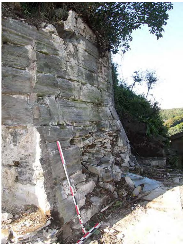
Fig. 87 : Exemple des dégâts occasionnés sur le glacis de la tour par les anciens aménagements de la maison détruite : ici par la cuve à fioul. Vue du sud-ouest. Cl. R. Pérennec 2015, CD29/ Mission Archéologie.
