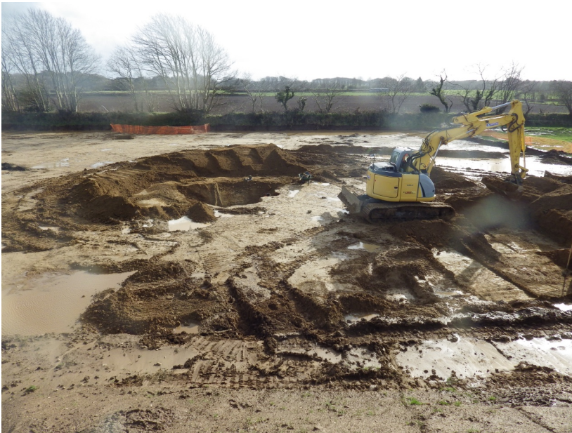
Fig. 42 – Vue du redécapage des environs du souterrain afin de mettre au jour des éventuelles galeries adjacentes. Mise au net : C. Sévin-Allouet © Éveha, 2016.
