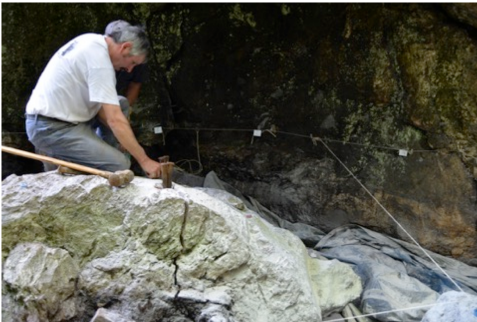
Figure 32. Fissuration du bloc à l'aide des coins de carrier (N. Naudinot).
