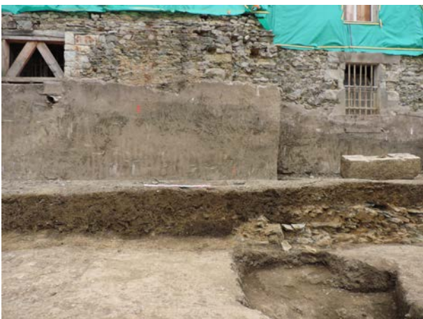
Fig. 4 Détail du mur gouttereau est du jeu de paume après le décapage archéologique. Le sommet de l'enduit ciment signale le toit du terrain avant le décapage archéologique de la parcelle 0234. Les dépôts visibles en coupes sont attribués à l'époque Moderne dont l'écorché de la maçonnerie 1006 © Cavanillas-Inrap, inv. 25.06.2014-352
