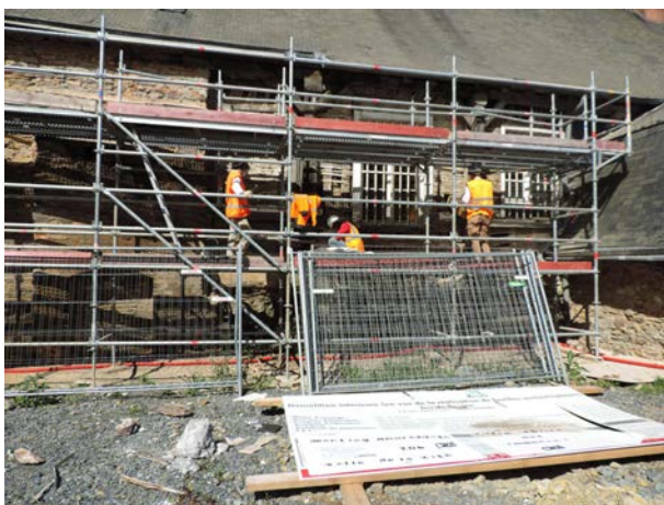
Fig. 7 Illustration de l'étude de la partie supérieure des élévations du côté est du bâtiment du Jeu de Paume avant le décapage mécanique © R. Ferrette-Inrap
