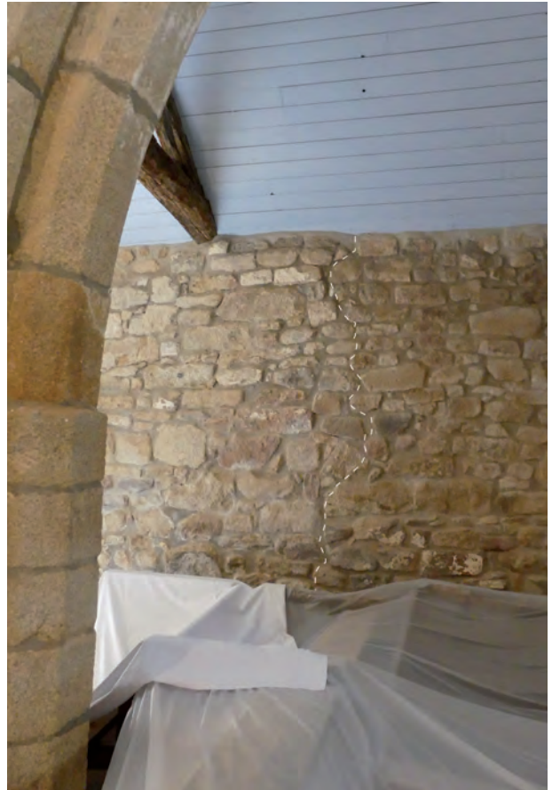
Fig. 18 Rupture dans l'appareillage du mur gouttereau sud © M. Millet, Inrap
