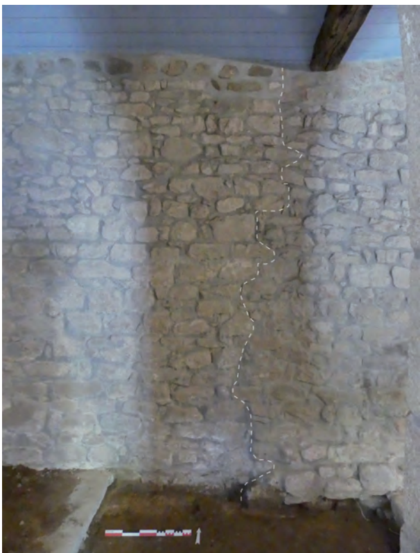
Fig. 13 Rupture dans l'appareillage du mur gouttereau nord © M. Millet, Inrap
