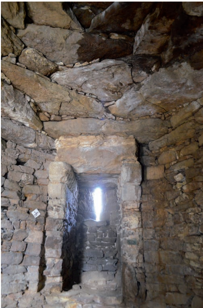
On remarque les infiltrations d'eau.
