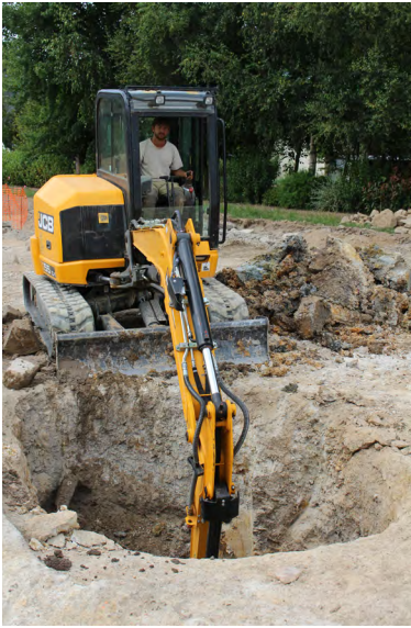
Fig. 156 - Fouille mécanique du puits 1378 : ce procédé a permis de descendre à 2,50 m de profondeur © Inrap.
