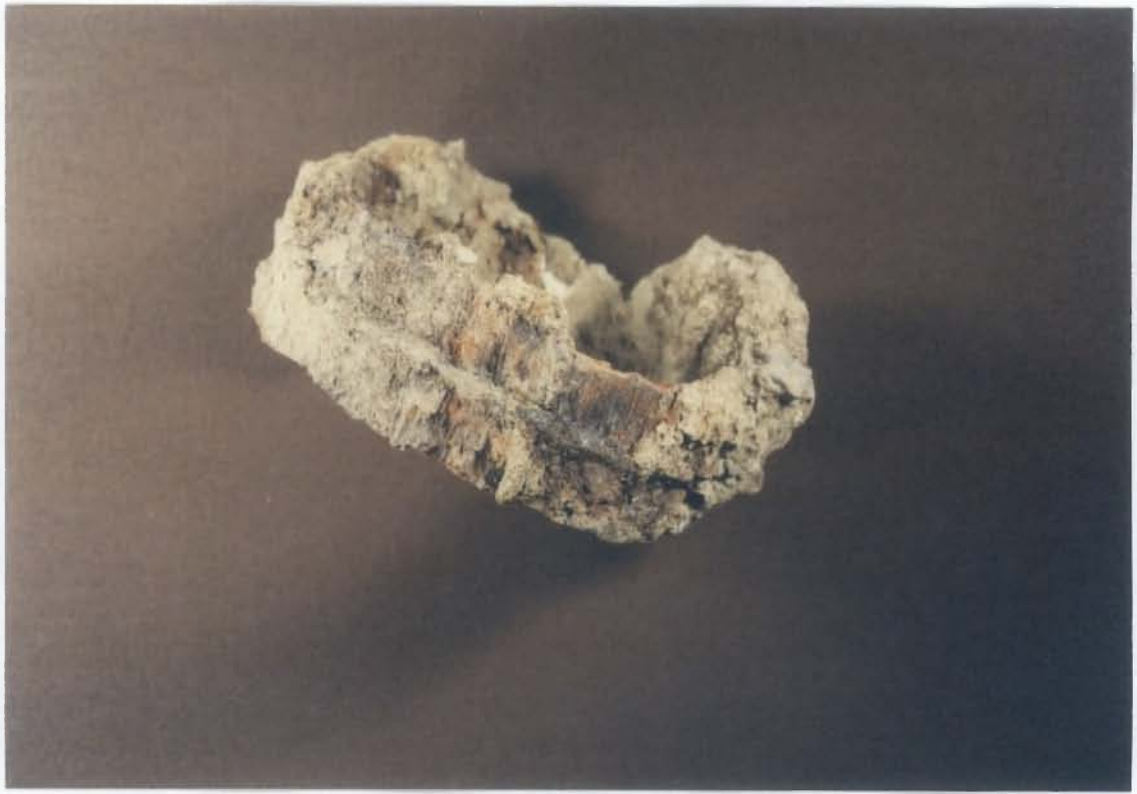
Cliché 16: frette d'assemblage de la canalisation, on distingue nettement des restes de bois fossilisé par l'oxydation.
