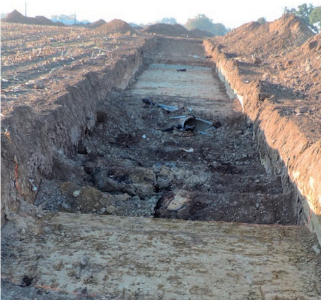
T5 - remblais : souches, plastiques, canalisation béton, métal...
