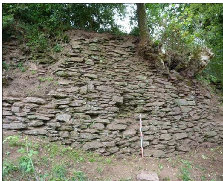
Photo 36 : Etat du mur ouest de la basse-cour après débroussaillage (M 501)
