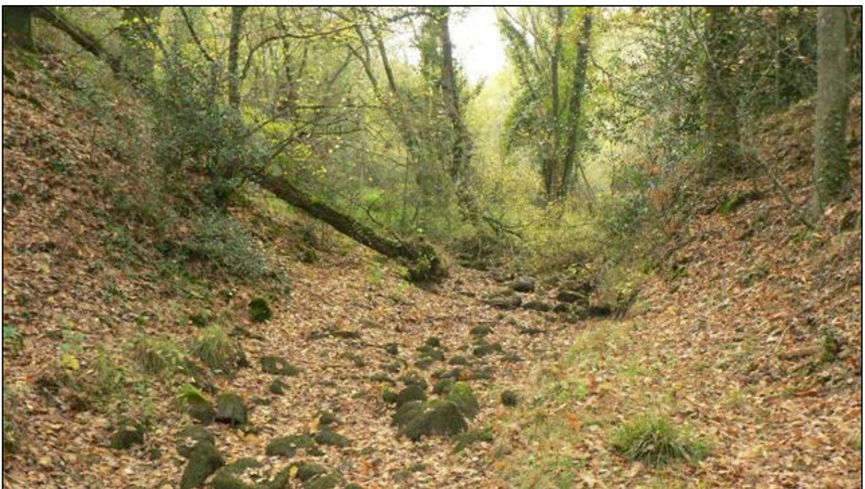
Photo 102 : La chaussée de l'étang éventrée et le ruisseau de la Charrière Marquée
