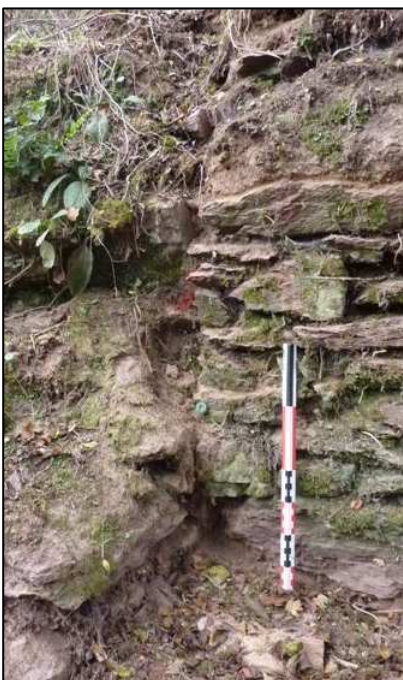
Photo 73 : Coupure entre contrefort M 520 et mur M 530
