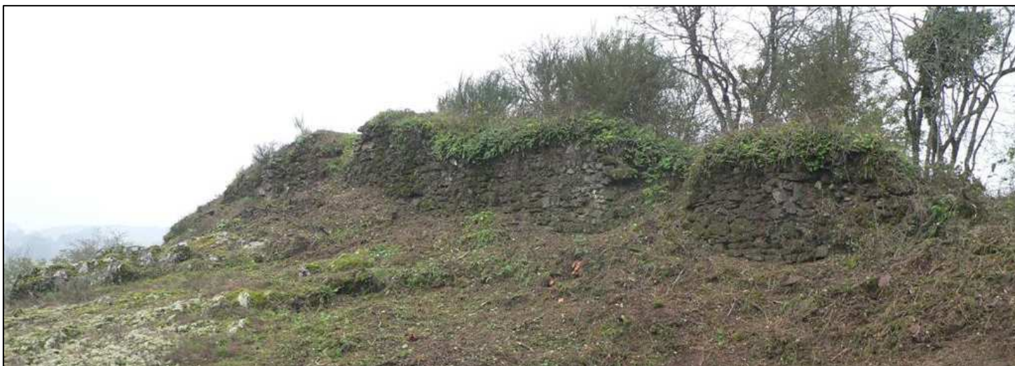
Photo 33 : Etat du mur sud-est de la basse-cour en 2005 avant restauration (cl. Ecomusée Montfort)
