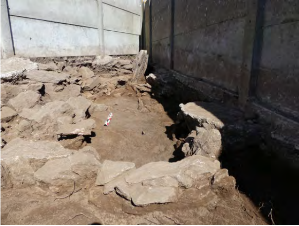
Fig.255 Vue vers le nord de l'UM 3006, à l'extrémité sud de la paroi ouest du couloir, dans l'emprise du diagnostic © E. Pierre
