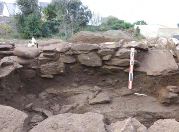
Fig. 134 Angle entre le muret ouest et le parement sud. En pointillé, limite entre les deux où l'on observe l'absence de chaînage © E. Pierre
