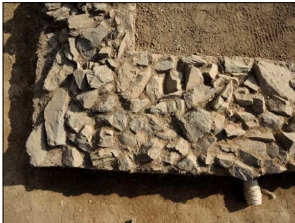
Fig. 10 : vue de détail de la fondation du mur extérieur de la galerie
