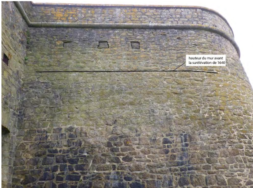
Figure 63: flanc ouest de l'orillon du bastion des Chambres. Coup de sabre marquant le rehaussement du bastion
