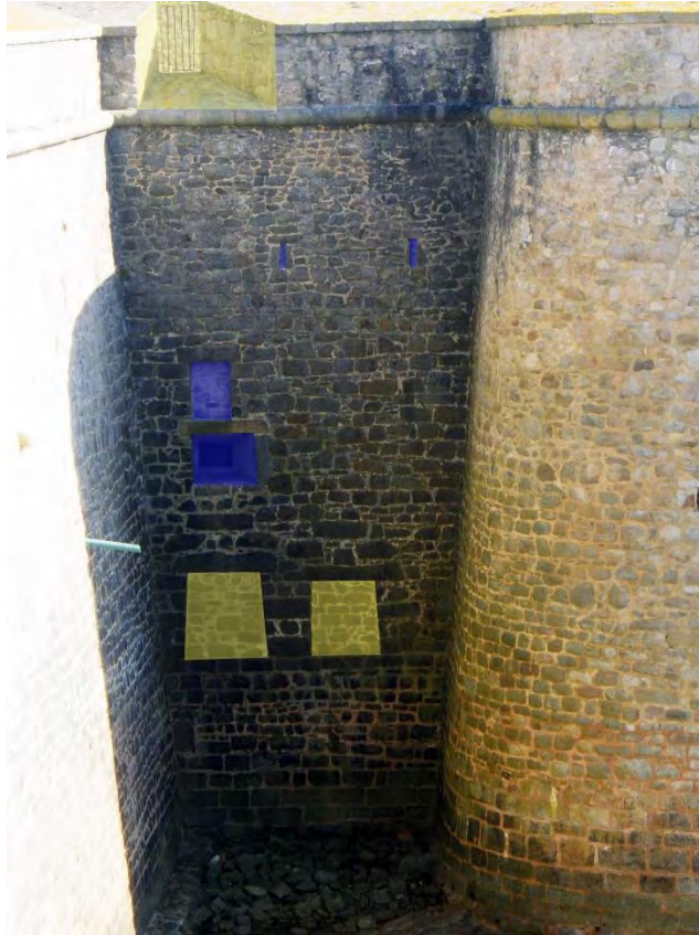
Figure 55 : sur les flancs nord et ouest du bastion de Groix, des barbicanes en partie haute sont ajoutées pour drainer les eaux et assainir les maçonneries.
