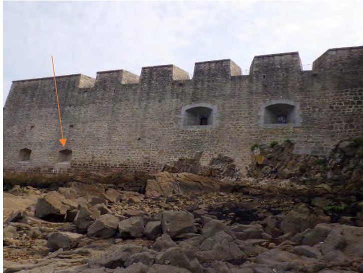
Figure 67 : deux ouvertures de tir bouchées en partie basse du front ouest du bastion du Camus. On observe aussi une césure verticale dans la maçonnerie du bastion jusqu'à +5m NGF pouvant témoigner d'une construction tardive du bastion comme celui de l'Irrégulier (après 1620 ?).
