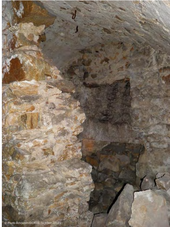
Figure 78 : casemate 3 du bastion de la Brèche (B. Egasse, 2012) : la casemate est adaptée au canon comme en témoignent l'ouverture basse et crochet de levage sur l'intrados de la voûte, surmontée d'un évent pour l'évacuation de la fumée. Elle a été emmurée par l'ajout du souterrain actuel dont le piédroit est visible sur le massif gauche de la photo. B. Egasse.
