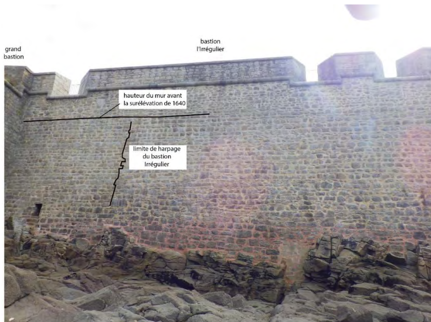
Figure 62 : front ouest du bastion Irrégulier, coup de sabre lié à la surélévation et limite de harpage au centre.
