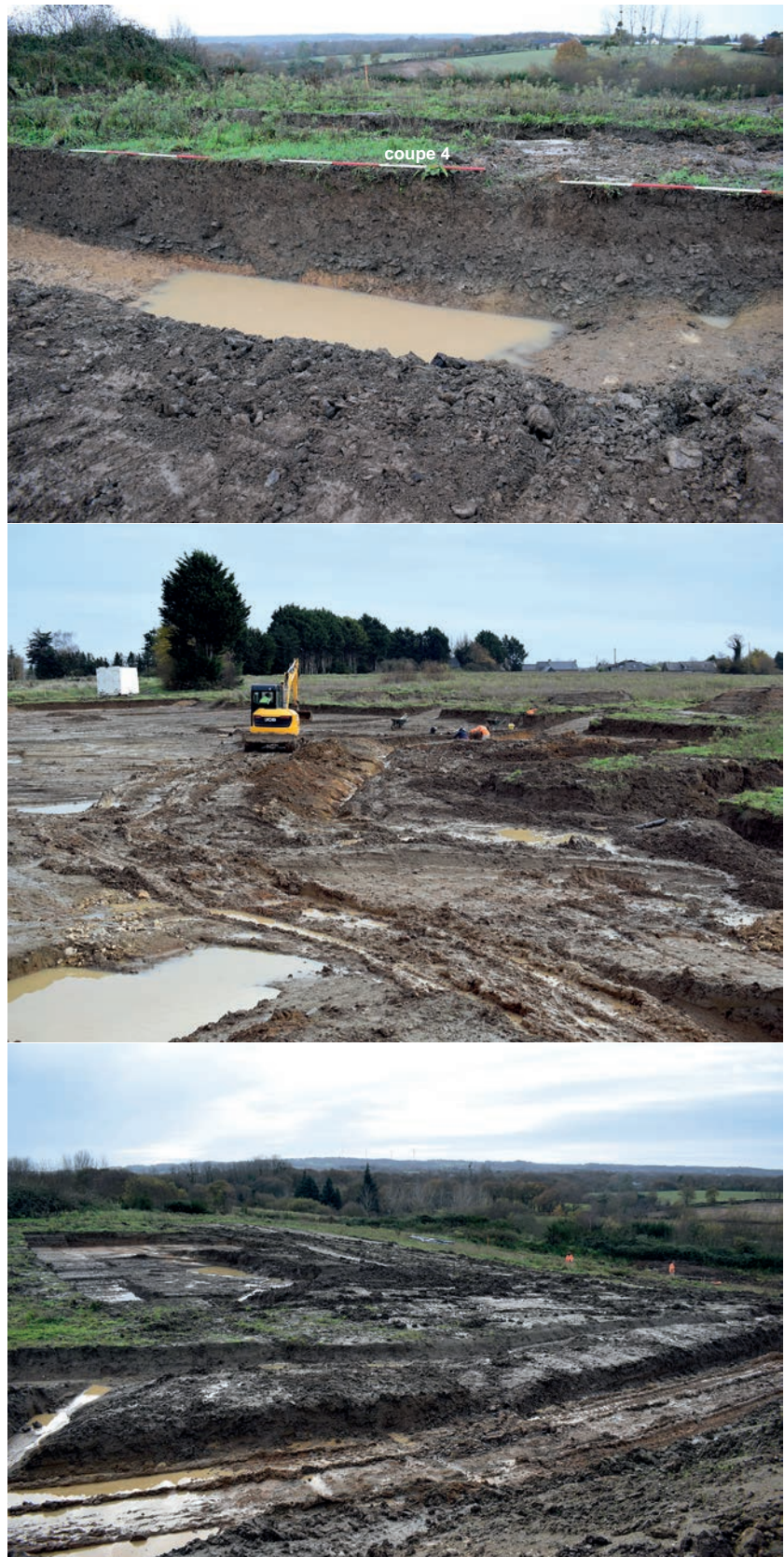
Fig. 71 Illustrations des modes d'intervention, mécaniques et manuels, pour l'étude de la voie protohistorique. De manière générale, elles montrent aussi les difficultés techniques rencontrées pour la réalisation des coupes et de l'écorché. © G. Leroux, Inrap
