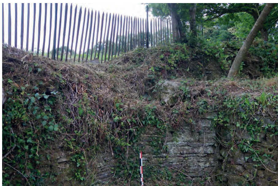
Illustration 49 : Détail d'une maçonnerie coupant l'angle nord-est de la salle B2-a. Une ancienne cheminée comblement d'une ancienne porte ? (Cl. J.-B. Vincent).
