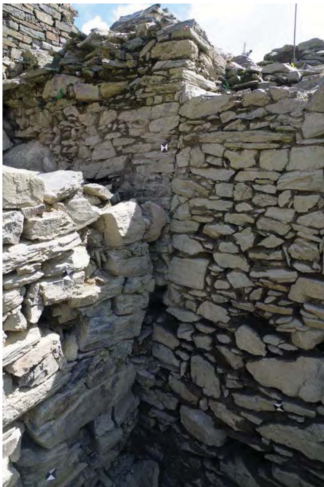
Fig. 24 : Détail de la structure M 2714 et du montant de la porte murée US 2706. Vue du nord-ouest. Cl. R. Pérennec, CD 29/ Mission archéologie.
