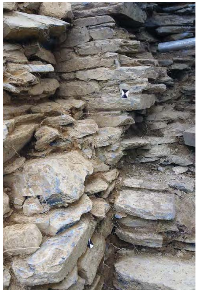
Fig. 82 : Détail du chaînage des structures M 2415 et M 2416. Vue de l'ouest. Cl. R. Pérennec, CD 29/ Mission archéologie.
