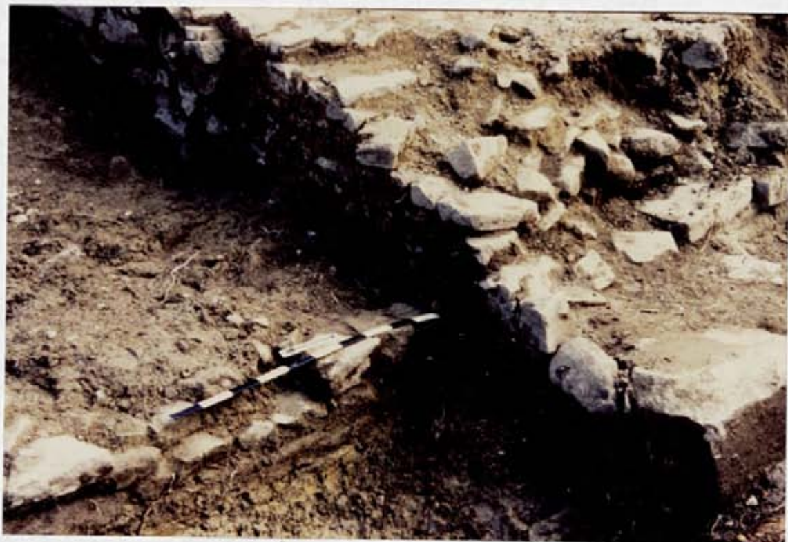
Cliché 11. Jonction des murs M9 et M4-M8 au niveau du contrefort C1.
