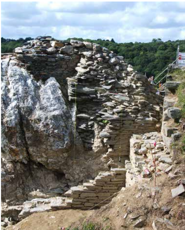
Fig. 55 : Les différents éléments successifs des fortifications au sud-est, articulés autour du rocher de quartzite, de la tour M35, de M43, jusqu'à un chemisage d'ensemble avec la courtine M40 (US 2238). Vue du sud. Cl. R. Pérennec, CD29/Mission Archéologie.
