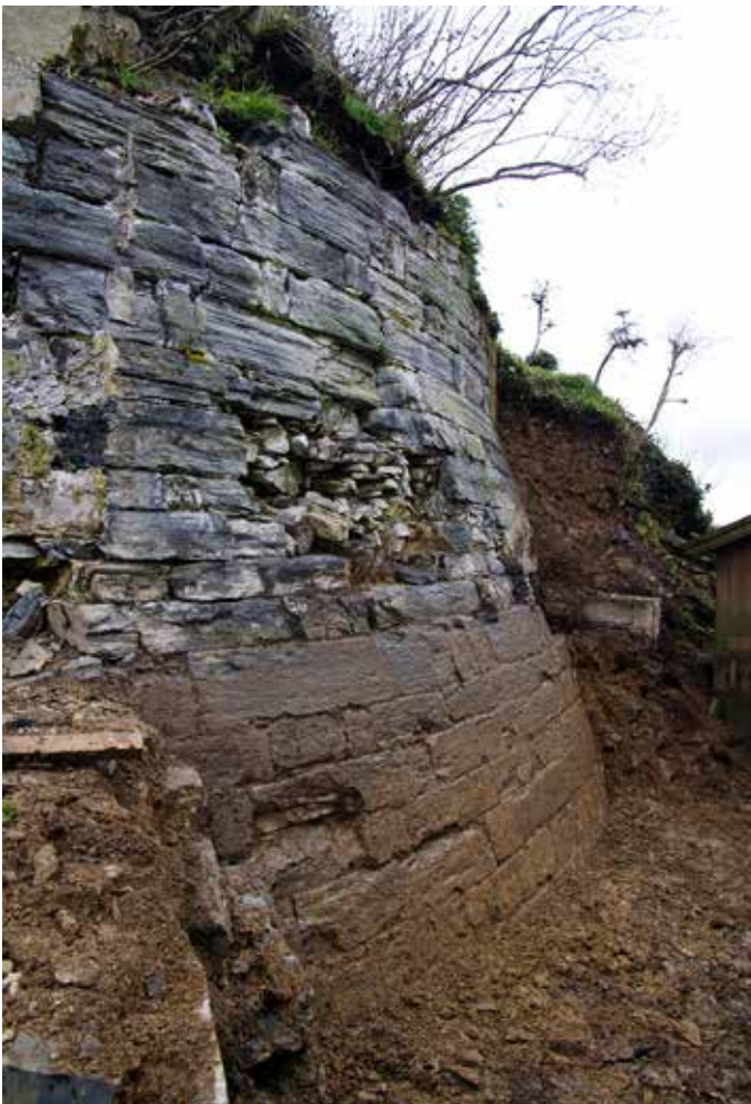
Fig. 99 : Les vestiges de la tour d'artillerie après suppression de la terrasse XXe siècle qui y était accolée au sud-est. La dégradation du parement résulte de l'installation d'une cuve à fioul US 3303. Vue du sud. Cl. R. Pérennec, CD29/ Mission Archéologie.
