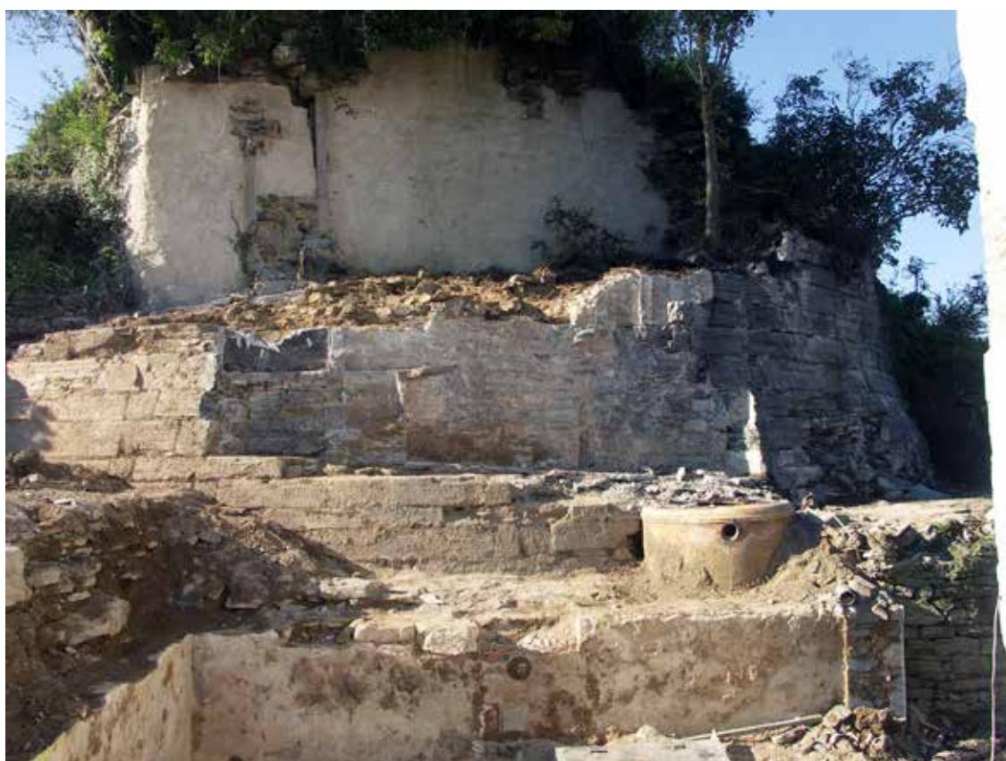
Fig. 96 : Vestiges du parement de la tour d'artillerie et de son glacis, côté sud. La disparition du parement, au centre, donne l'emprise de l'appentis de la maison. A l'arrière-plan, le blocage interne est étayé et enduit, pour éviter son effondrement. Cl. R. Pérennec 2015, CD29/ Mission Archéologie.
