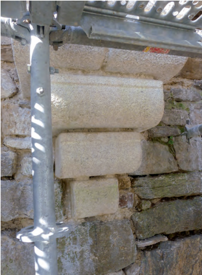
Fig. 11 Console de mâchicoulis remplacée © R. Battais, Inrap
