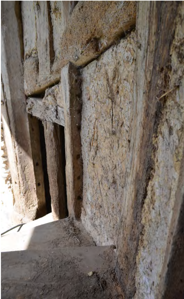
Fig.115 Les tournoises remplacées © M. Millet, Inrap une tour maçonnée. Le sondage pratiqué au sol n'a livré aucune fondation. Le substrat est apparu très vite. Le pan de bois pouvait reposer sur un solin qui a été démonté depuis.
