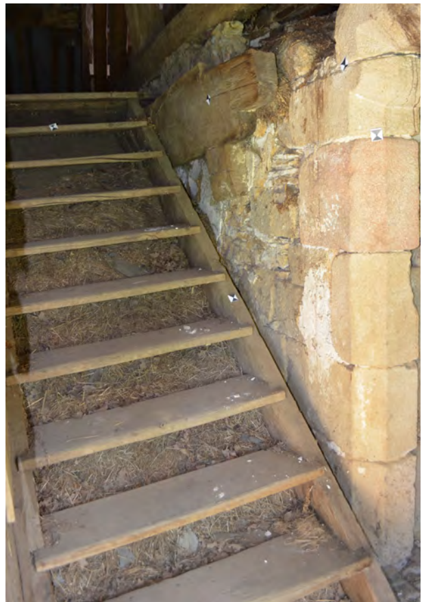
Fig.134 L'escalier à vis tronqué et son remplacement pour l'accès aux combles © M. Millet, Inrap
