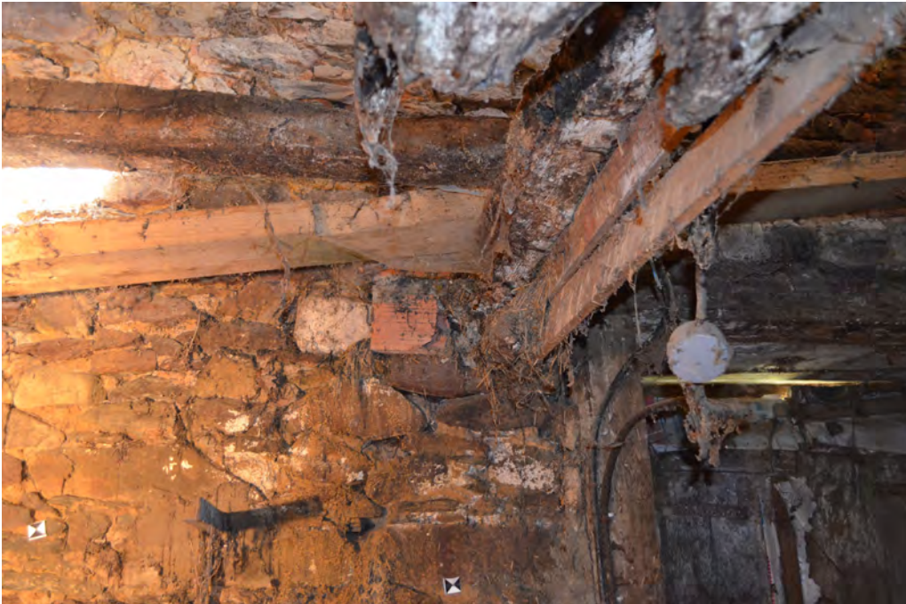
Fig.56 L'about de poutre abîmé © M. Millet, Inrap
