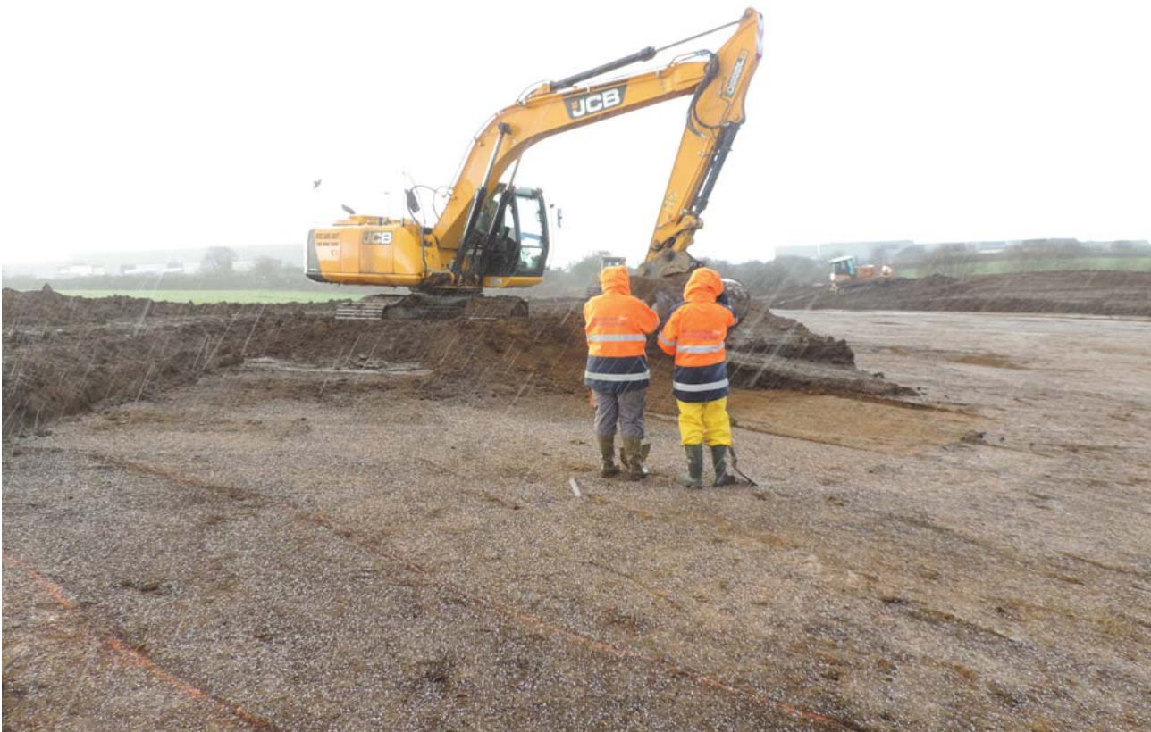
Fig. 1-5 Guipavas (29) - ZAC de Lavallot Nord, décapage sous la grêle © B. Simier, Inrap.
