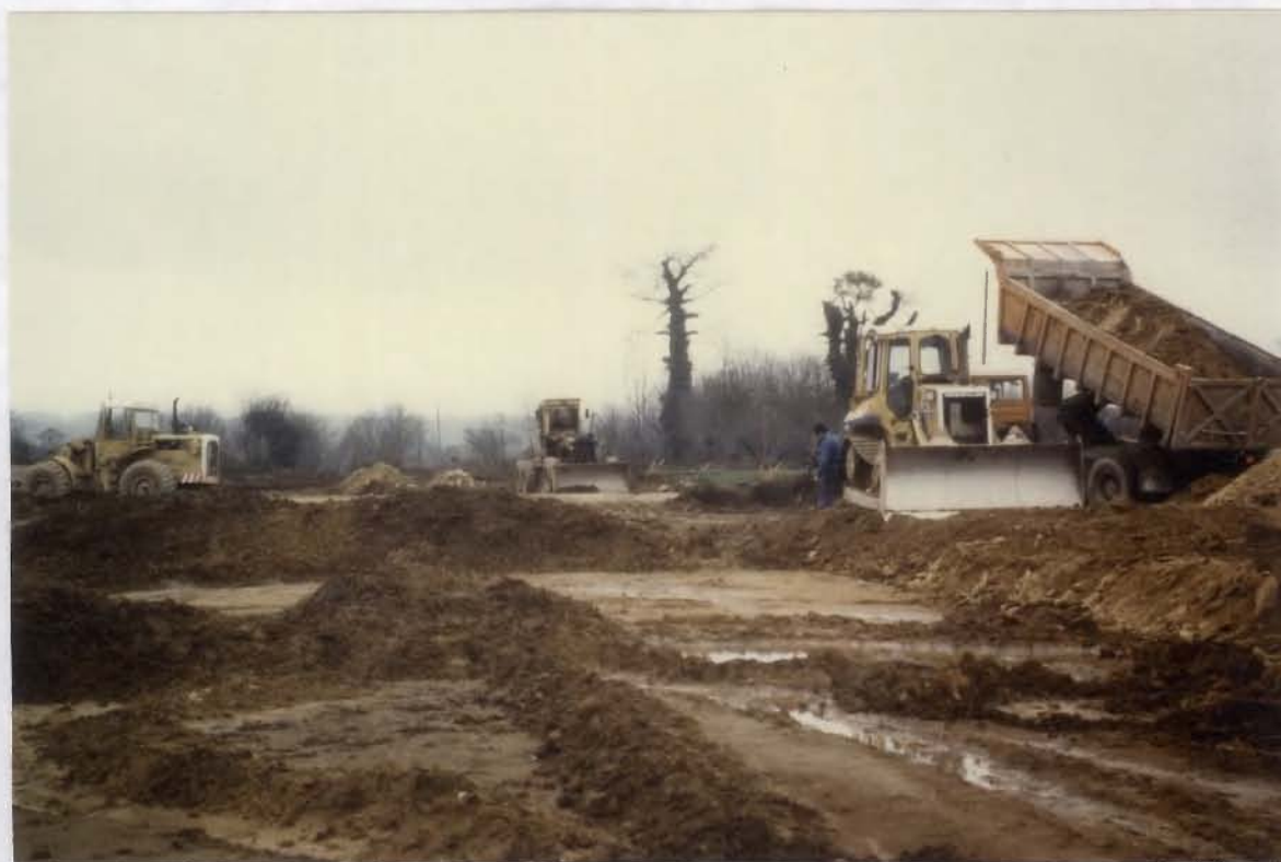
Tentative de décapage dans la boue.
