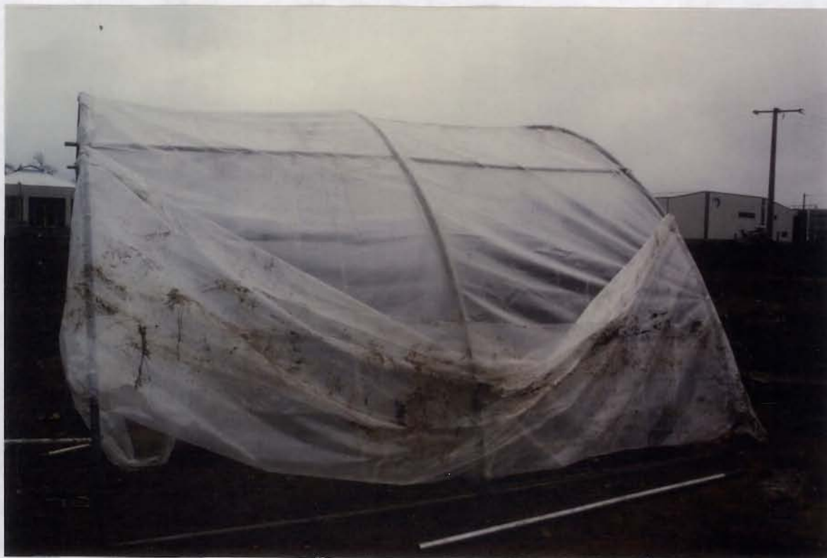
Abri de chantier arraché par la tempête.
