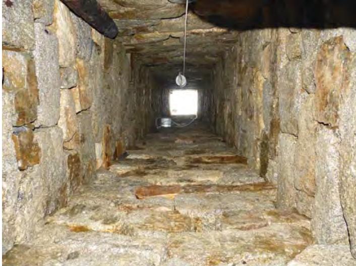
Fig. 7. Vue du cuvelage depuis sa partie basse (en haut de la photo : parement nord). Cliché J.-M. Féménias.
