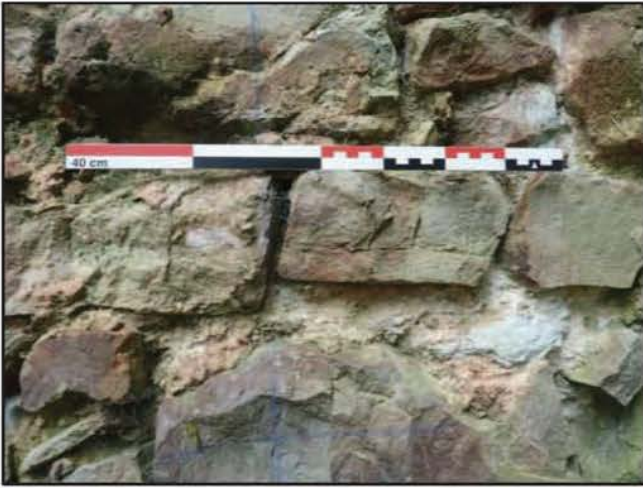
Photo 28 : Appareillage en grès et mortier ayant chauffé dans le parement intérieur de la tour
