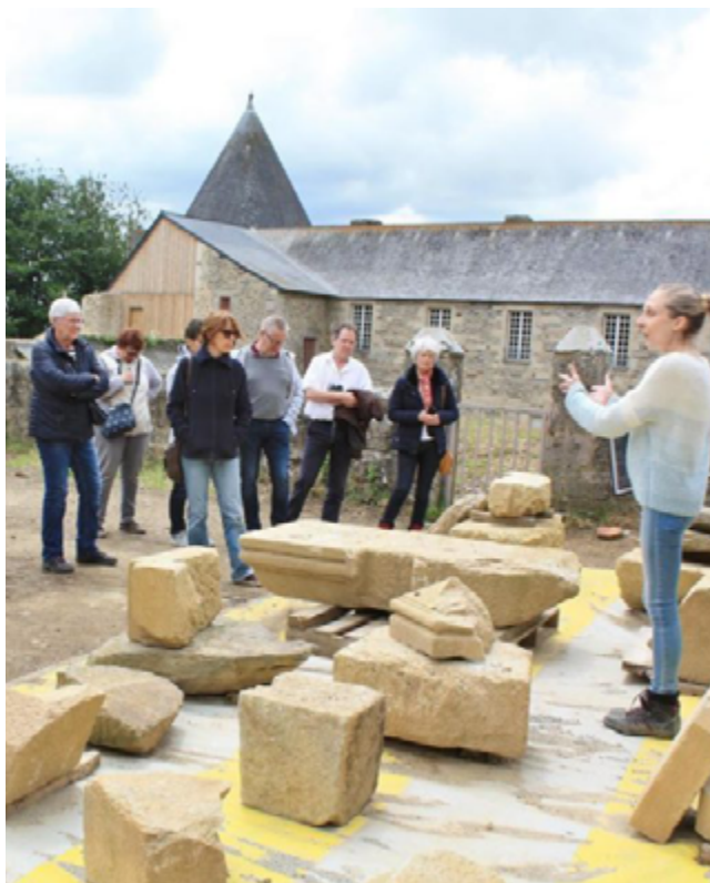
Fig. 26 - Visite du chantier de fouille par Anne Bocquet (médiatrice du patrimoine à la ville de Pontivy) (Cliché Pontivy journal, 14/06/2019) et ci-contre, affiche des journées du Patrimoine de pays et des moulins.
