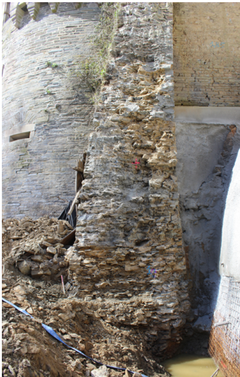
Fig. 44 - Vue en coupe de M2 (partie ouest de la courtine sud). On distingue en bas à droite les remontées d'eau au niveau des fondations.
