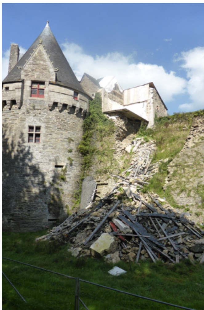
Fig. 67 - Destruction des bâtiments du XVIII e siècle lors de l'effondrement de la courtine en février 2014 (Cliché Jocelyn Martineau)
