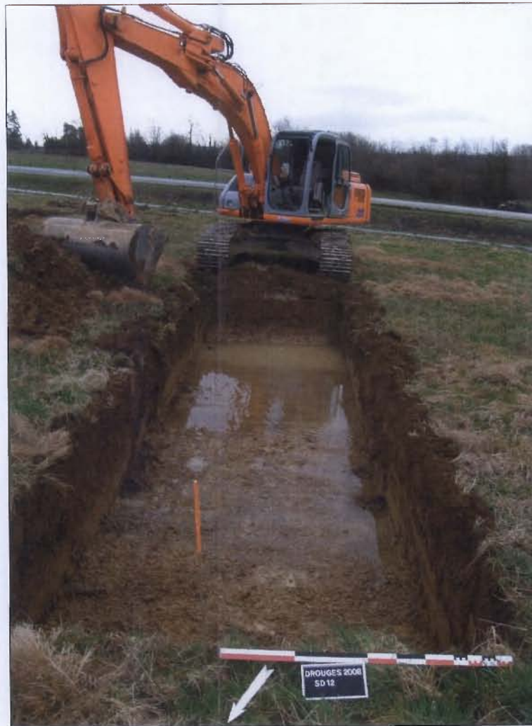
FIG 6 : VUE DU SONDAGE 12 INONDÉ PAR LES REMONTÉES D'EAU
