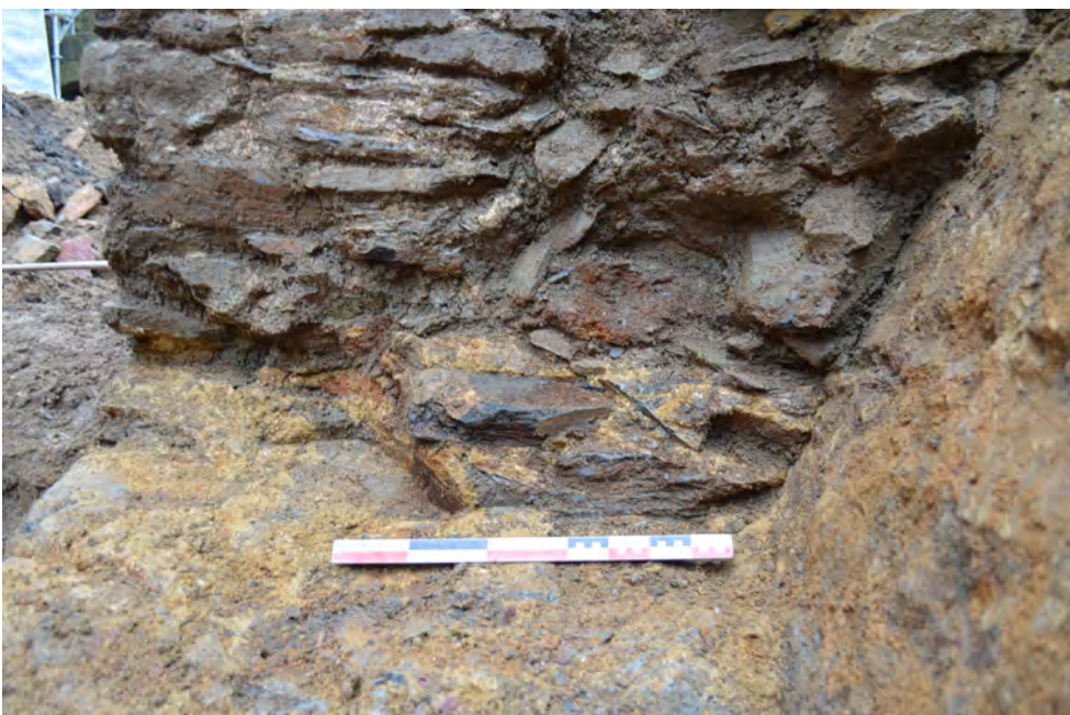
Fig.68 Détail des différences de mortier © M. Millet, Inrap
