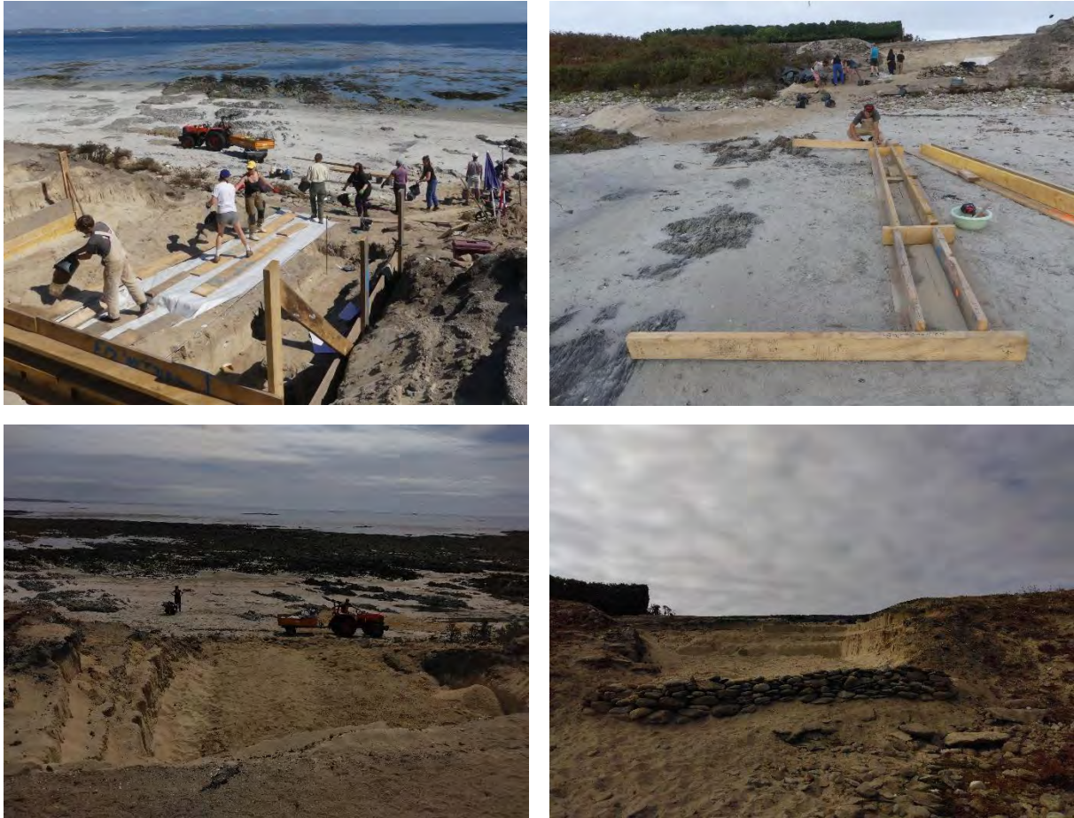
Fig. 55 – Fin de campagne 2022. Protection des niveaux archéologiques avec du géotextile et des planches, démontage du coffrage en bois, rebouchage partiel du sondage, construction d'un mur en pierre sèche en haut d'estran.
