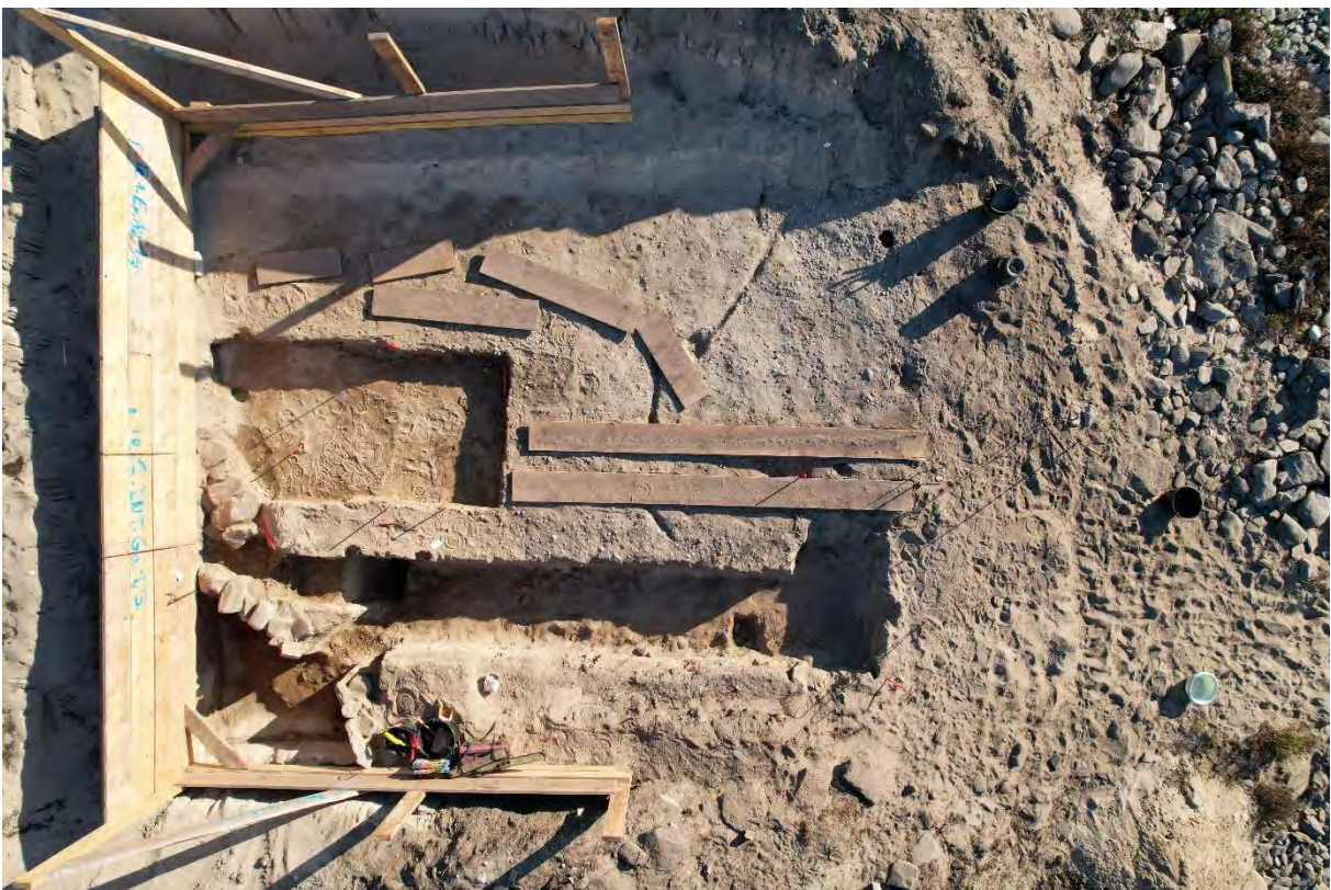
Fig. 52 – Coffrage en bois qui protège les fouilleurs et le site des éboulis et planches pour le déplacement sur site (photo C. Nicolas).
