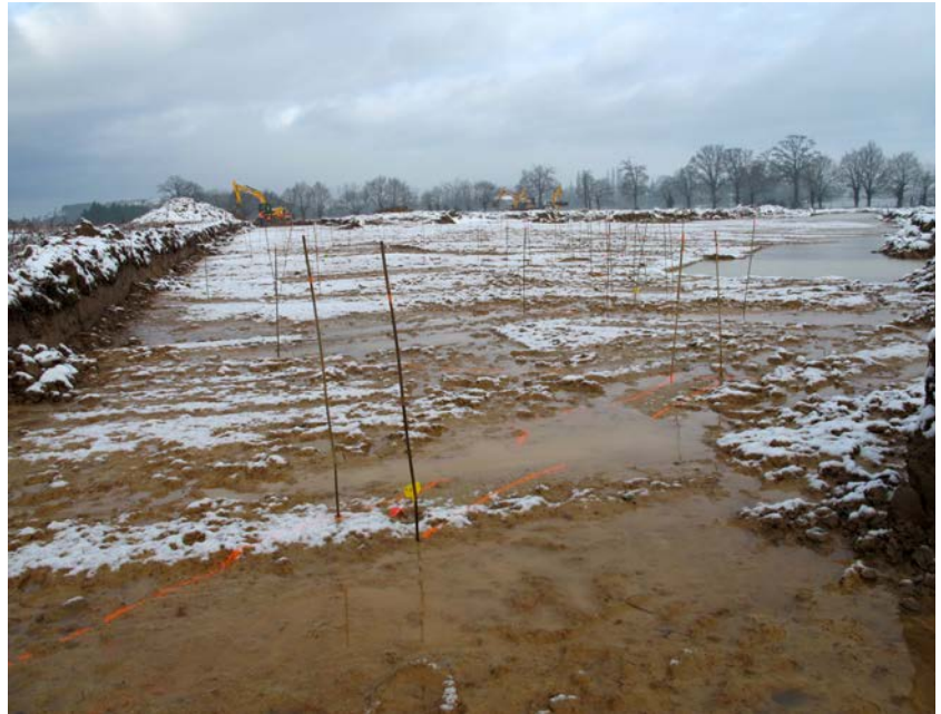
Fig. 9 : vue générale de la zone décapée du secteur 1 du sud vers le nord © J.-C. Durand
