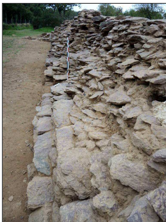
Photo 16 : semelle débordante à la base du mur
