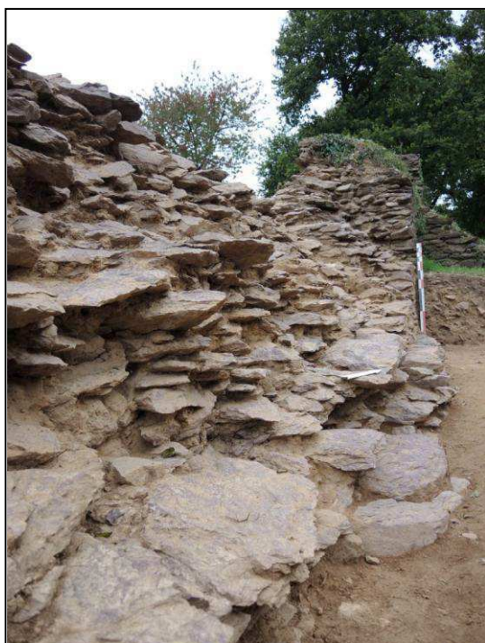
Photo 15 : arrachement des pierres vue sud
