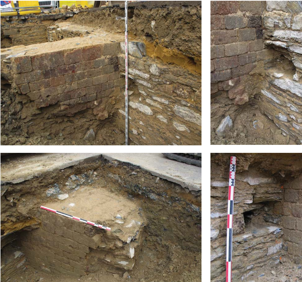
Fig.30-33 : L'examen du chaînage des maçonneries révèle que celles-ci ne sont pas contemporaines © Dominique Pouille
