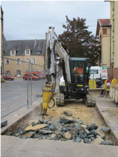
Fig.22 : La présence d'une épaisse dalle de béton a nécessité l'utilisation d'un brise roche pour poursuivre le sondage © Arnaud Desfonds
