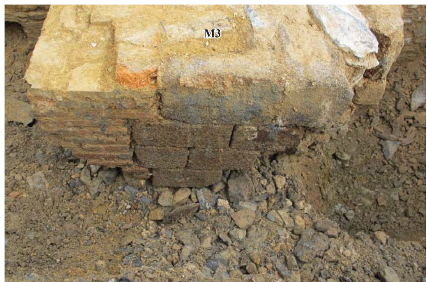
Fig.29 : Face sud du contrefort M3 on voit nettement ici que le parement de briquettes se substitue au parement d'origine en blocs de granit © Dominique Pouille
